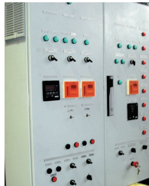
Шкаф управления к вакуум-фильтру ДОО-100
